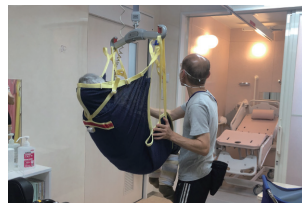
▲浴室の天井走行リフト
